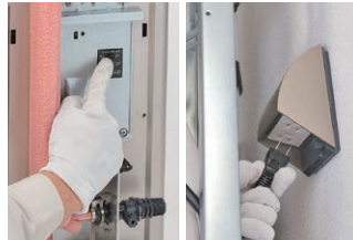
ヒートポンプユニット ガス熱源機
